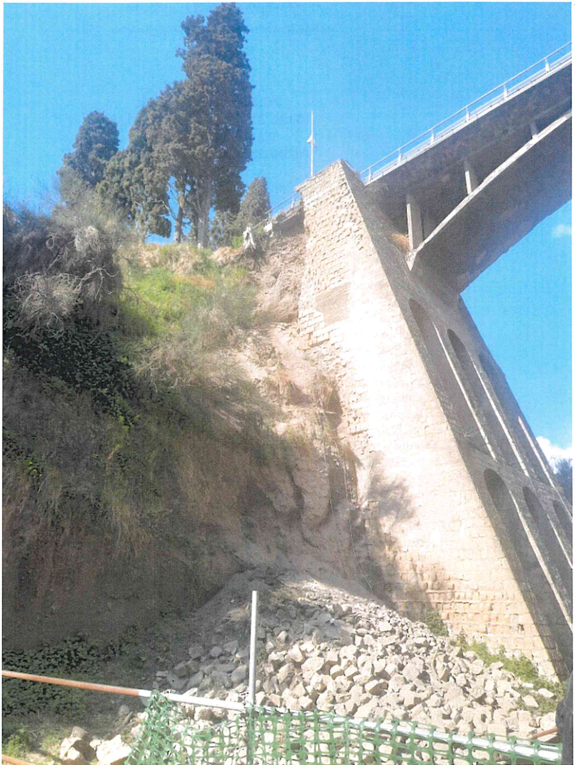
Particolare della zona interessata dal crollo
